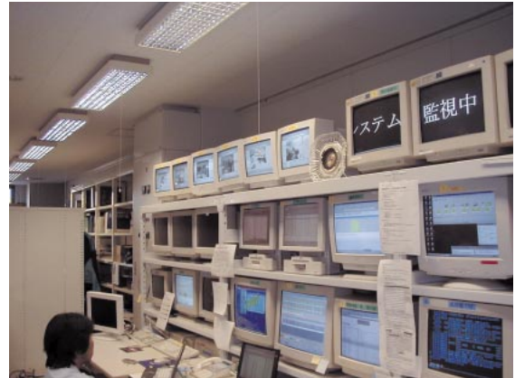
図5 管理センター内の様子
