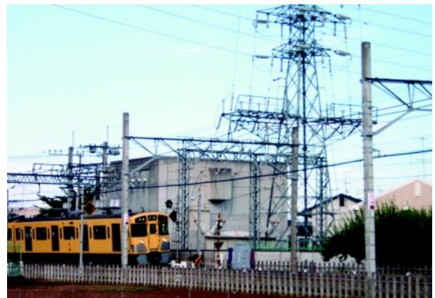
図1 鉄道用変電所の例
