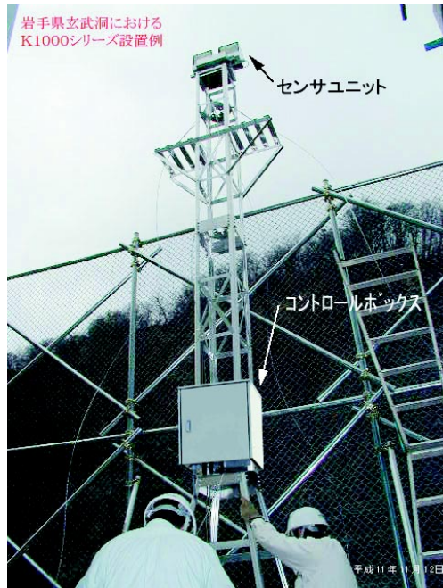
図1 微小移動量検知センサの外観と設置作業の様様
