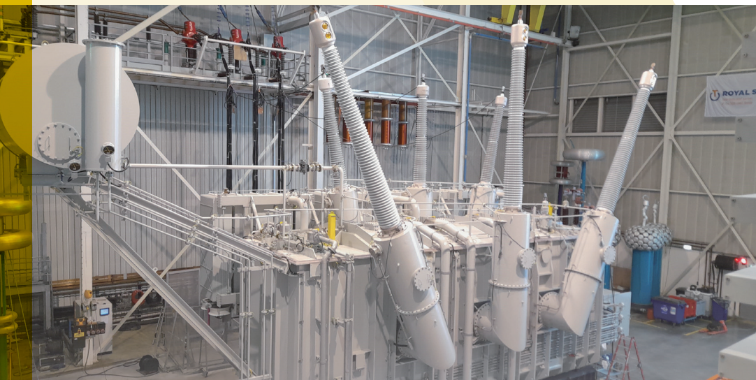
Royal SMIT Transformers社 高圧テストラボ(写真提供:Royal SMIT Transformers社)
