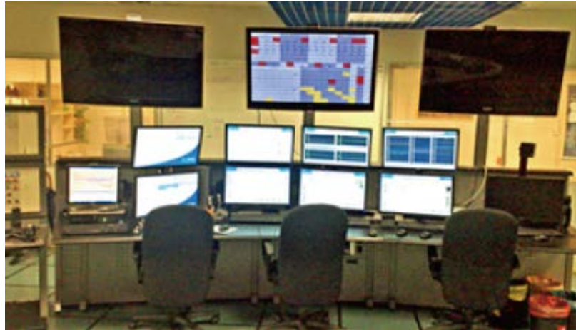
中央監視制御室
