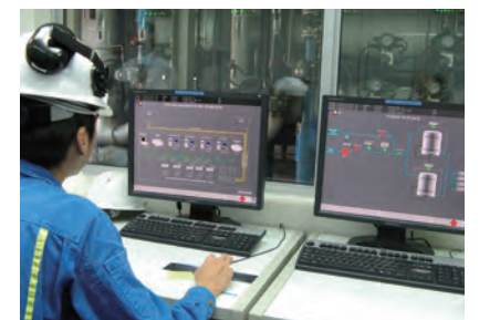
用于现场操作的主控制室
