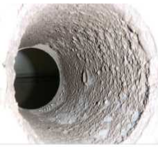
AXR 2 線式電磁流量計 ライニング内面付着状況
