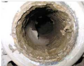
既設 4 線式電磁流量計 ライニング内面付着状況
