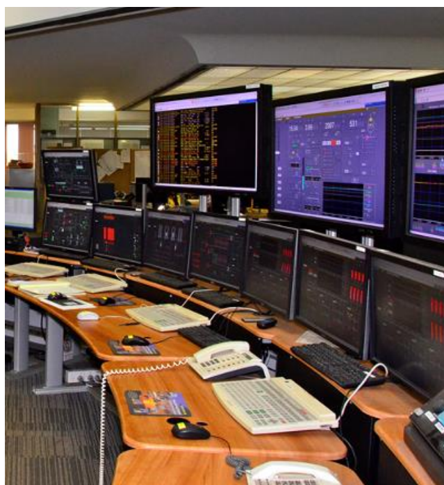
Part of the new Loy Yang control room layout
